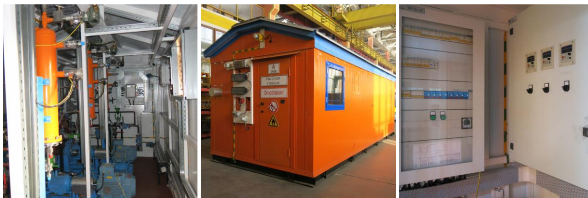
Рисунок 3. Насосная станция ГПМ-НС-К-5.
