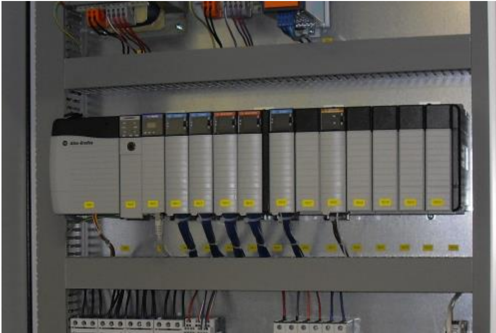
Контроллер ControlLogix в ШКУ ГРС «Кропоткинская»
