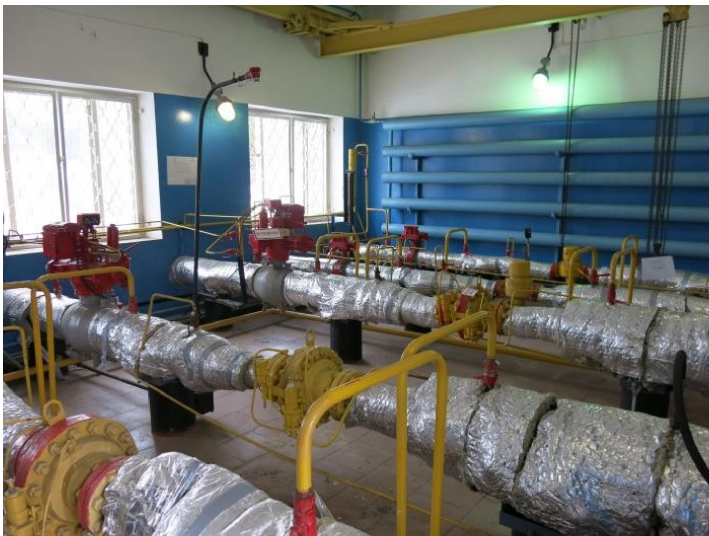
Подлежащая капитальному ремонту ГРС Эжва (г. Сыктывкар)
