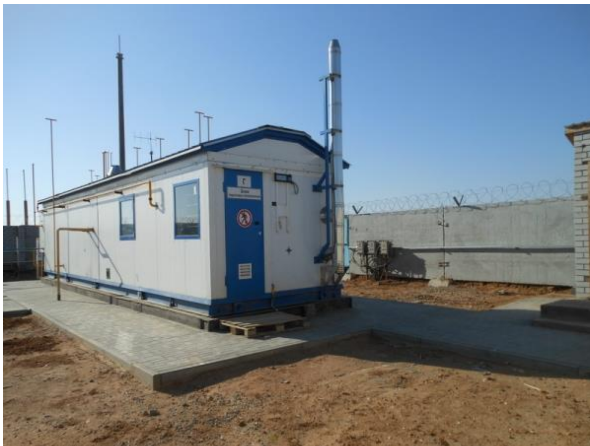
АГРС «Газпроммаш» на объекте ООО «Газпроммаш трансгаз Ставрополь»
