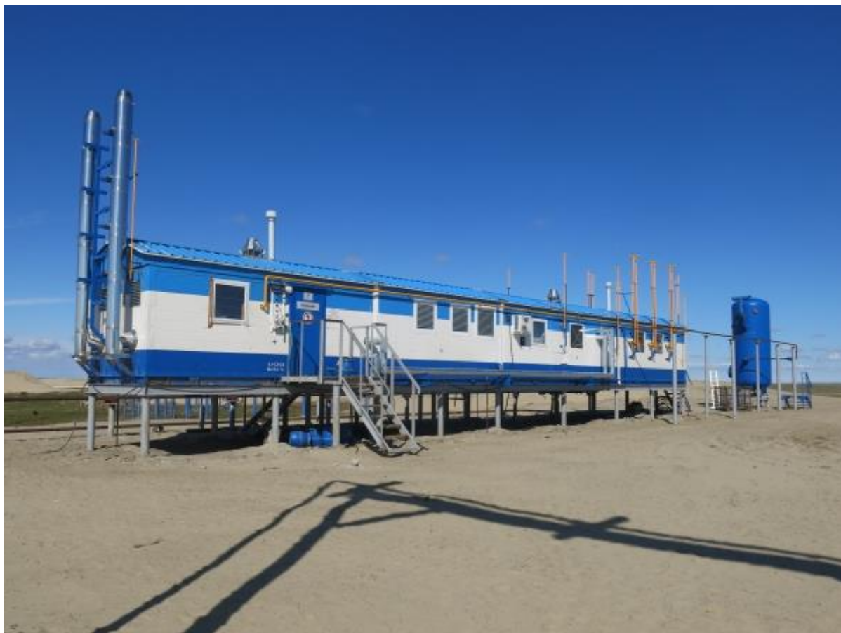
Блок подготовки газа на Салмановском газоконденсатном месторождении
